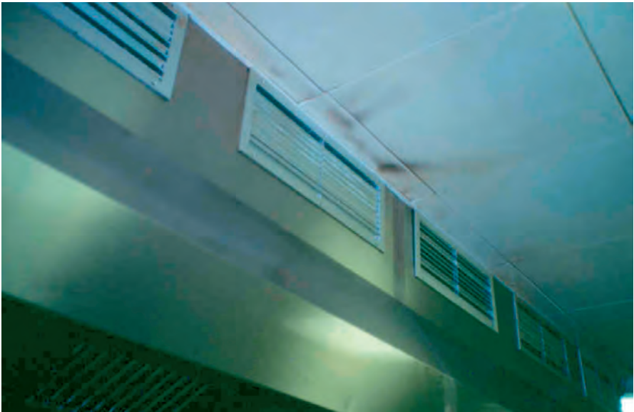
Abb. 8: Bei diesem Zuluftdurchlass kommt es zu Schmutzablagerungen (Schmutzfahnen) an der Decke.
