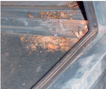
Abb. 3: Schmutzablagerungen und tote Insekten vor dem Außenluftfilter sind regelmäßig zu beseitigen.
