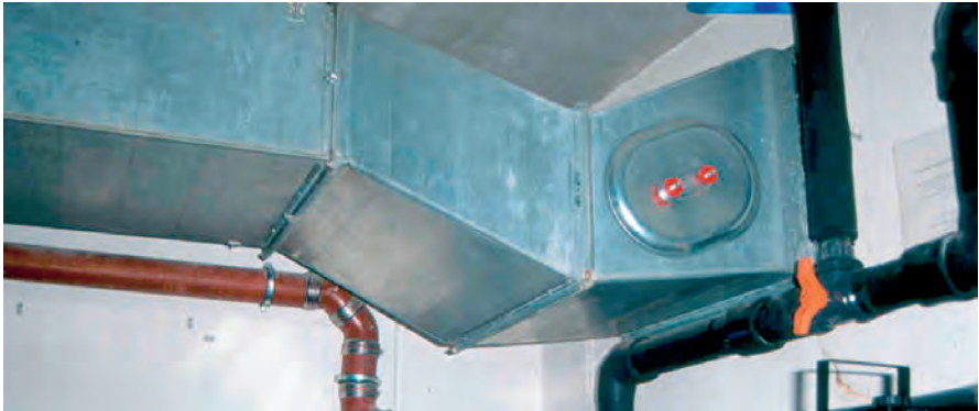
Abb. 5: Außenluftleitung mit Revisionsöffnung zur Kontrolle der Luftleitung innen.
